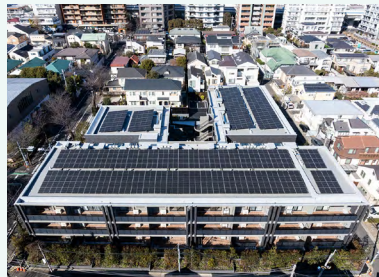
本物件屋上一面に設置された太陽光パネル
