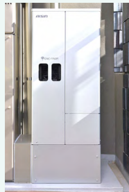
住戸に設置されたエネファーム
