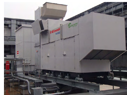
非常用発電機
